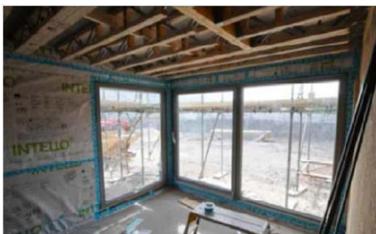
a) Vapour barrier membrane.
