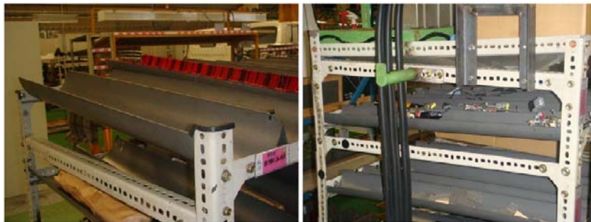
Fig. 45 – Caneletas dos racks com elevadas dimensões
