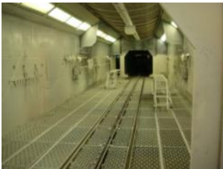
Fig. 11 - Túnel de Aplicação do Esmalte e do Primário
