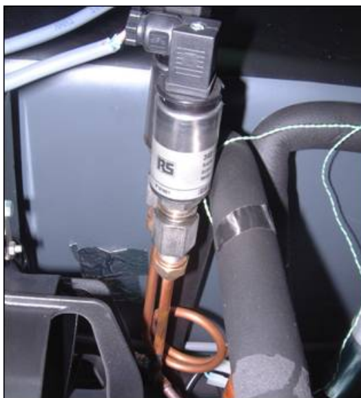
Figura 5.2: Sensor de pressão montado num circuito.
