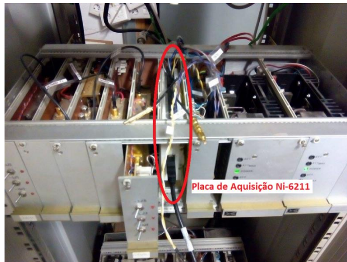
Figura 2-14 - Sistema de receção do sinal KA (interior)
