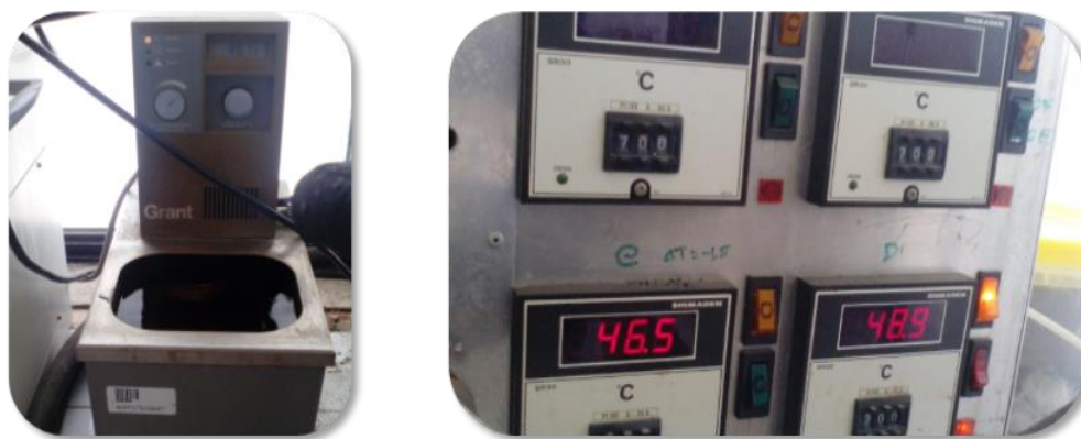
Figura 19 – Exemplo de um dos banhos de aquecimento utilizados (à esquerda) e detalhes da unidade de controlo térmico da instalação (à direita)
