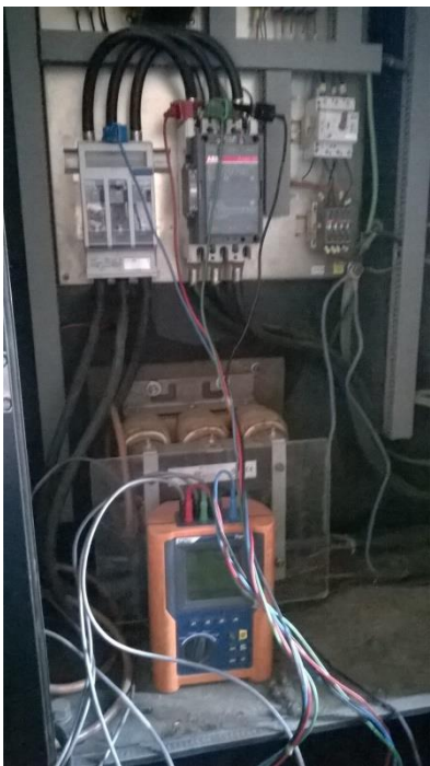
Figura 37. Compressor - Pormenor do quadro eléctrico parcial
