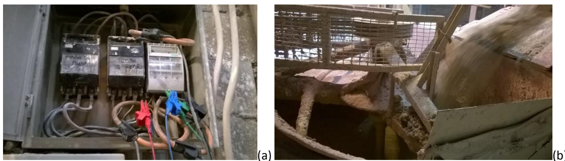
Figura 19. Sector da pasta –(a)Pormenor do quadro eléctrico parcial dos Moinhos, durante medição (b) Vista do moinho, aquando carga.
