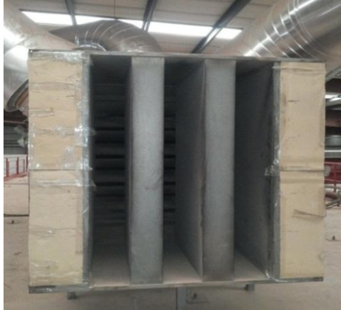
Figura 4.8 - Preparação para a medição do caudal e ar novo na admissão principal
