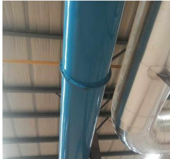
Figura 4.24 - Conduta de extração dos gases de exaustão do túnel de espera e conduta da contrapressão do secador
