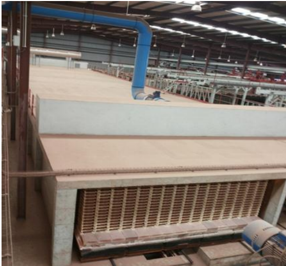
Figura 4.23 - Conduta de extração dos gases do túnel de espera do forno
