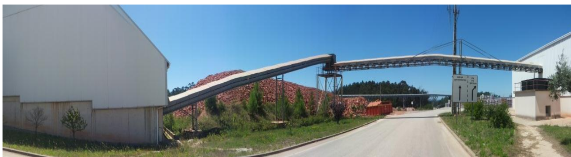
Figura 3.6 - Tela transportadora da preparação de pastas para a Fábrica IV
