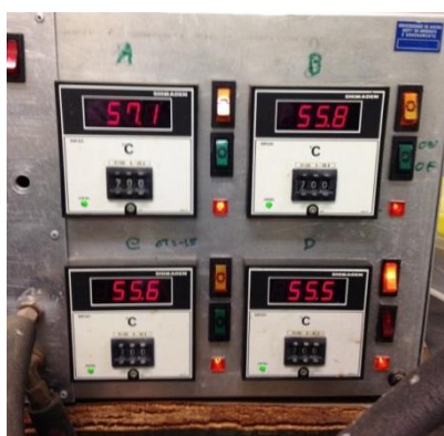
Figura 17: Unidade de controlo térmico da instalação.
