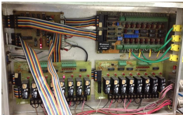
Figura 19: Unidade de controlo da instalação.
