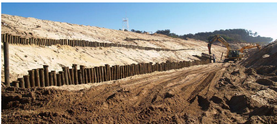
Figura 58 – Construção da obra costeira por estacaria frontal na praia de Maceda (Fonte: DA-CMO, Dezembro de 2013).
