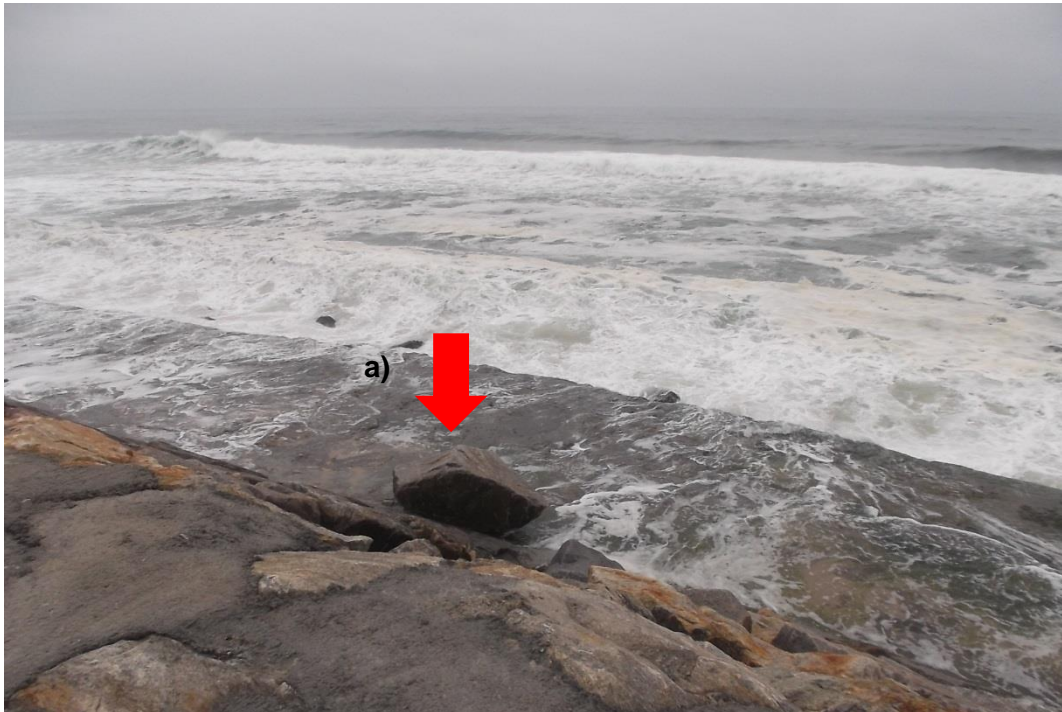
Figura 40 – Desencaixe de um bloco do talude do enrocamento superior, observando também o galgamento costeiro da 1ª base da defesa aderente DA5, na praia de Cortegaça (Fonte: DA-CMO, 4 de Junho de 2015).
