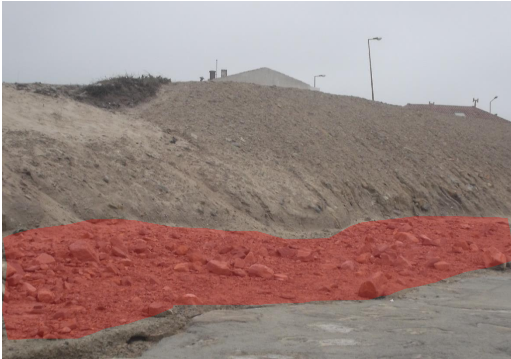
Representação das consequências dos galgamentos costeiros sobre a DA5 na praia de Cortegaça, caracterizada pela erosão do pé do talude da marginal (Fonte: DA-CMO, 6 de Junho de 2015).
