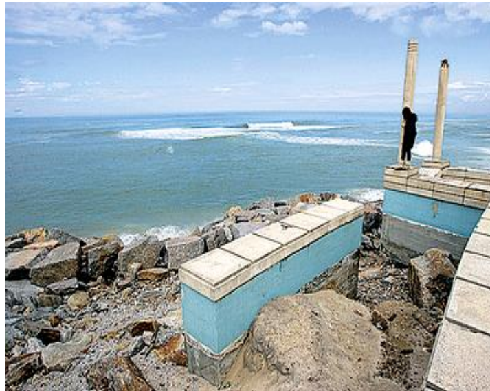
Figura 50 – Destrução de parte do muro que separa a praia da Avenida. Marginal da praia (Fonte: retirado de Público, 2010).
