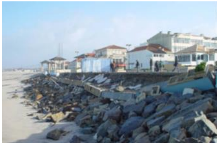
Figura 51 – Desabamento do muro que separa a praia da Avenida Central da praia (Fonte: Anónimo, retirado DA-CMO, 2001).
