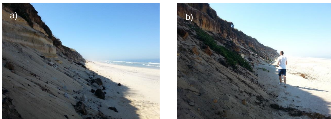
Figura 36 – Monitorização da linha de costa e perfis de praia, no troço sul da praia de Maceda. a) Abatimento da escarpa talhada do sistema dunar; b) Levantamento da linha de costa 2015 (Fonte: DA-CMO, 28 de Maio de 2015).
