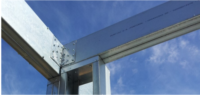
Figura 83– Parafusos (Obra da PRORUAN - Albergaria-a-Velha).
