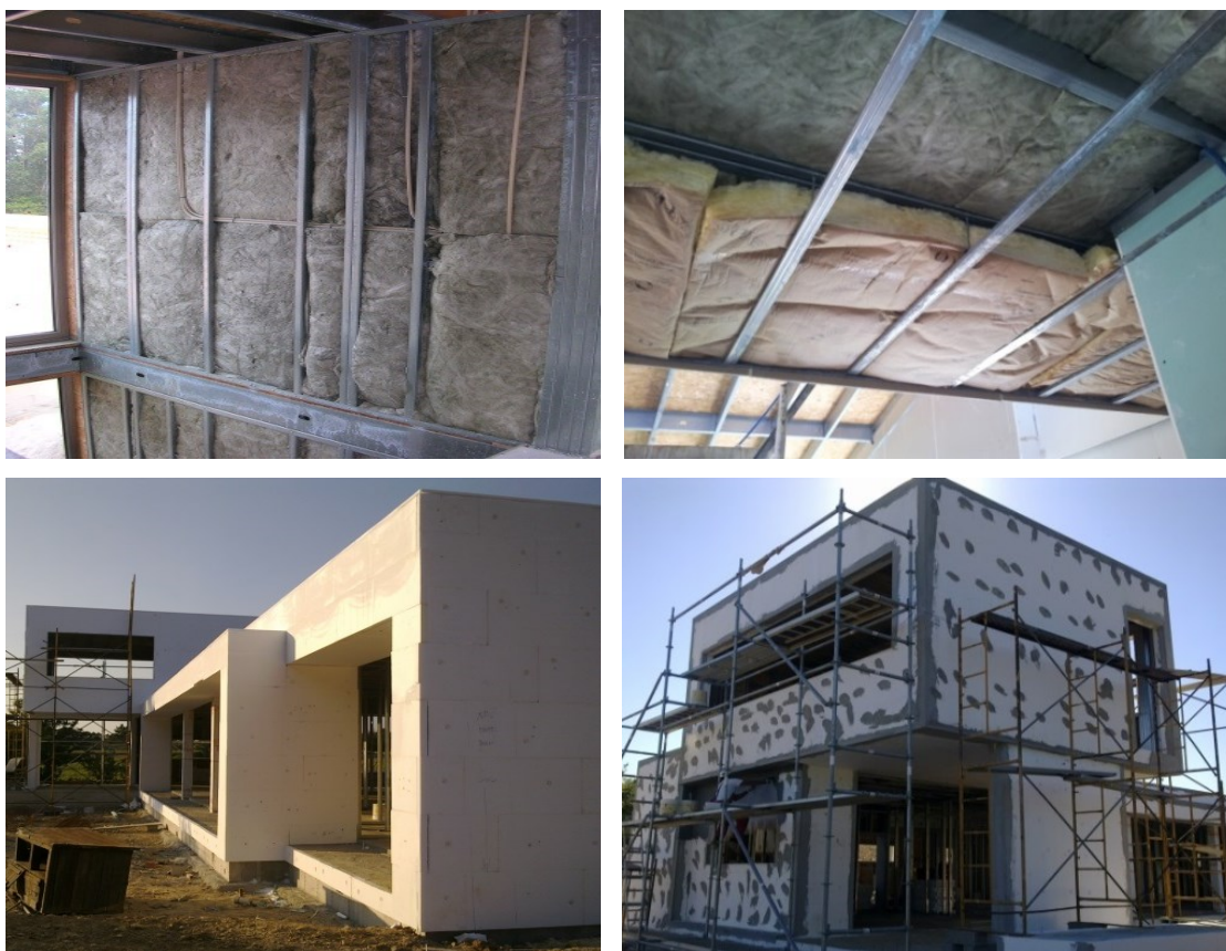
Figura 5– Isolamento acústico com lã mineral pelo lado interior e isolamento térmico em EPS pelo lado exterior. (Obra da PRORUAN - Albergaria-a-Velha).
