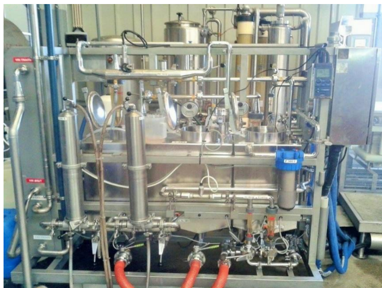
Figura 10- Instalação de eletrodialise.
