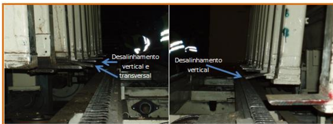
Figura 36 - Desalinhamento das garras do Luki .
