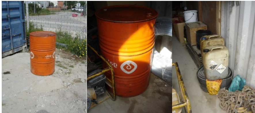
Figura 21 – Acondicionamento não conforme dos produtos químicos no estaleiro afeto à obra
