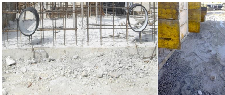
Figura 26 – Presença de betão endurecido no solo afeto ao estaleiro da obra, na zona de execução de estruturas pré-fabricadas em betão
