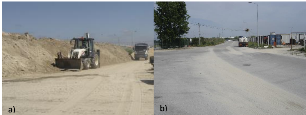
Figura 14 – a) Terreno do estaleiro afeto à obra; b) Acumulação de poeiras na via adjacente ao estaleiro afeto à obra
