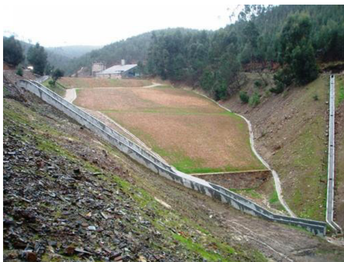
Figura 2.30 – Aspetos finais da recuperação ambiental na antiga área mineira de Terramonte. Foto posterior a 2008 (fonte: http://www.edm.pt/html/proj_terrmonete.htm ).
