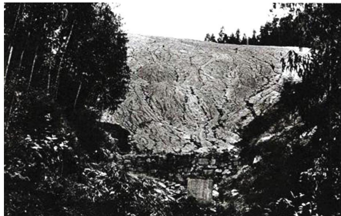
Figura 2.24 – Vista do talude da frente da escombreira com sulcos e deslizamento de materiais (fonte: Nascimento, 1975a).
