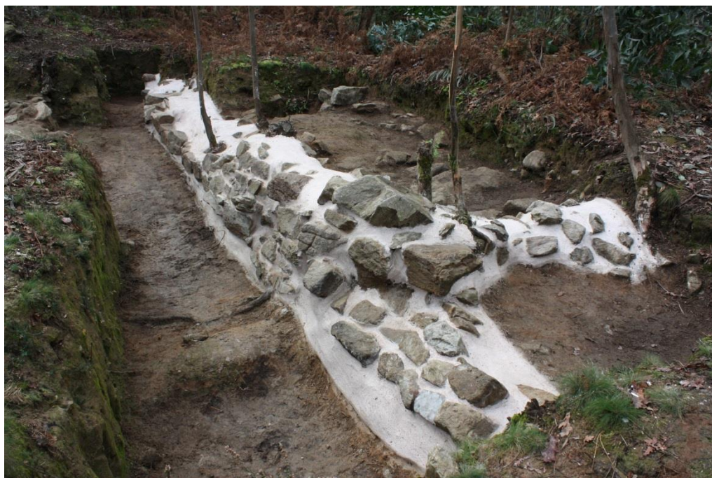
Figura 5.6 - Vista Norte-Sul da muralha do Sector B após a conclusão da intervenção de consolidação (Tavares, 2014b).
