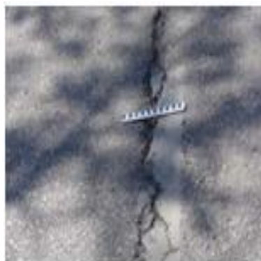
Figura 8 - Fenda longitudinal (Alves, 2007)
