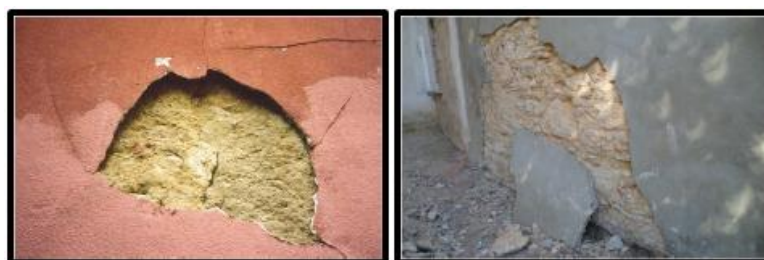
Figura 3 – Camadas de acabamento de substituição de cimento: destacamento e degradação da estrutura (Veiga, 2006)
