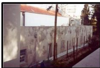
Figura 2 – Reboco bastardo de substituição com cerca de 2 meses: degradação devido a sais higroscópicos (Veiga, 2006)
