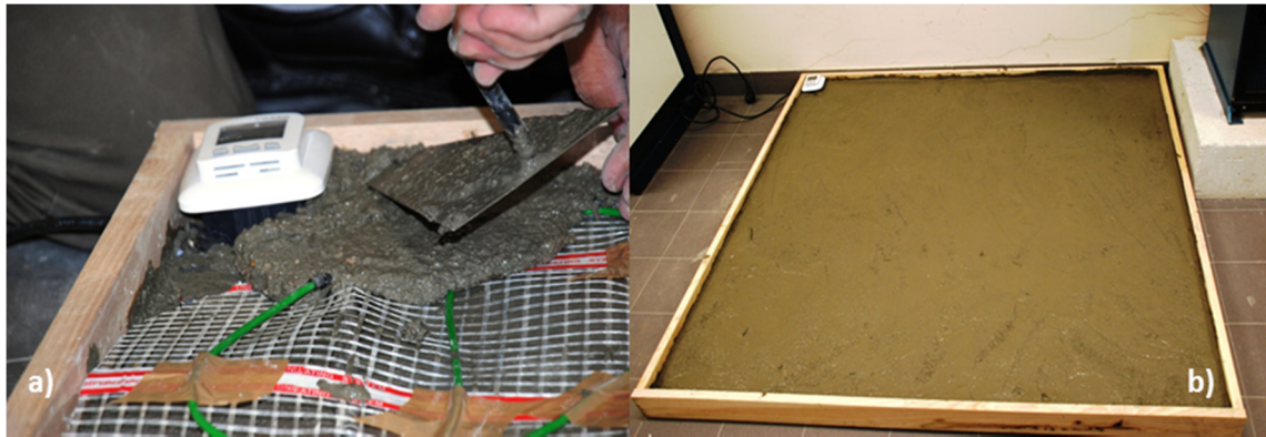
Figura 89 - a) Colocação da camada de argamassa por cima da tela; b) Aspecto da superfície devidamente regularizada.
