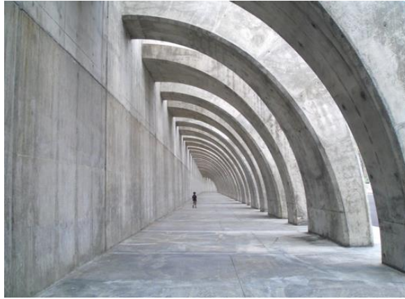
Figura 2.1- Local onde a utilização de betão autocompactável seria apropriada (retirado de www.engenhariacivil.com )
