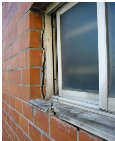
Figura 4: Instabilidade das paredes de alvenaria
