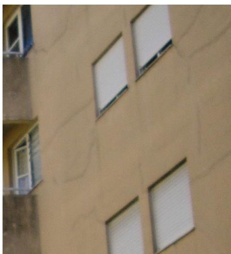
Figura 2: Fissuração nas fachadas
