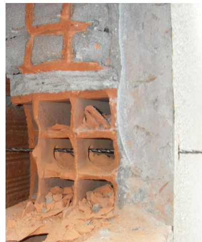
Figura 6: Espessura do reboco exagerada (aproximadamente 7cm)
