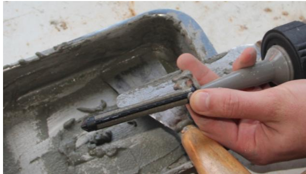
Figura 46: Obstrução com cimento cola das mangas.
