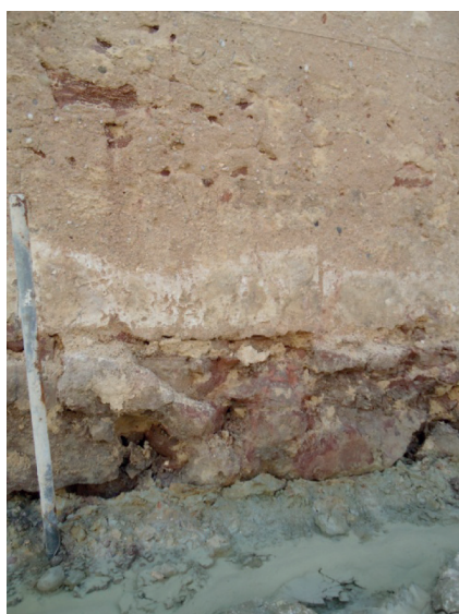
Fig. 39- Pedra de Eirol assente diretamente na argila
