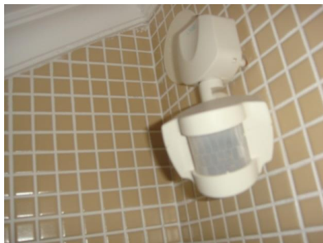
Figura 77 - sensores de presença (Interativa)
