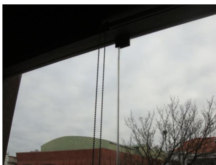
Figura 92 - Isolamento inexistente - vãos (Fusion)
