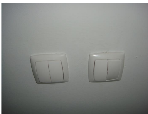
Figura 101 - Identificação de interruptores inexistente (Fusion)
