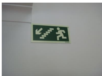
Figura 63 - Sinalização de emergência aplicada (escadas)
