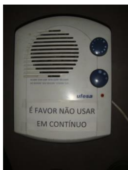
Figura 44 - Identificação de alerta (termo-ventilador)
