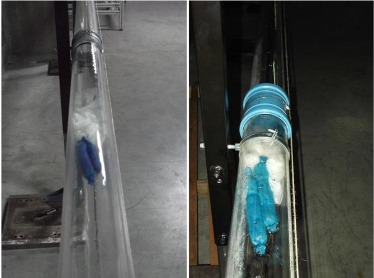
Figura 32. Aglomerado depositado num ramal de DN110 (à esquerda) e num de DN90 (à direita)
