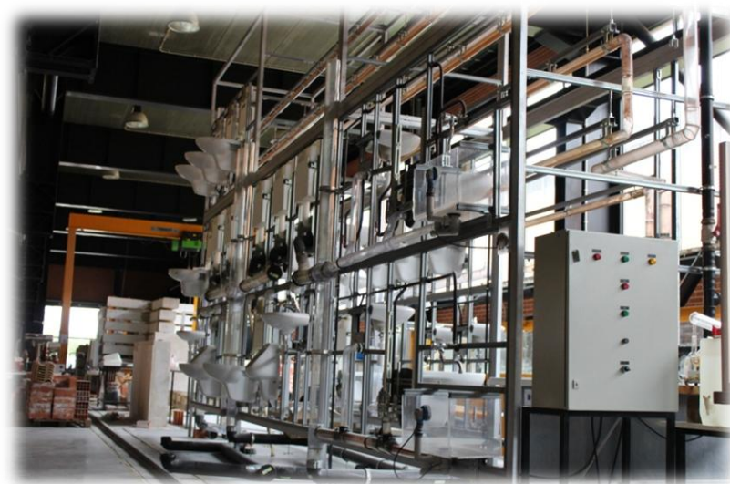
Figura 38 - Torre hidráulica do Departamento de Engenharia Civil da Universidade de Aveiro (U.A.)
