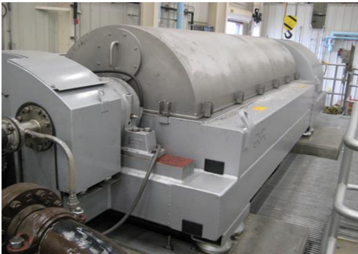
Figura 17 - Centrífuga de desidratção de lamas
