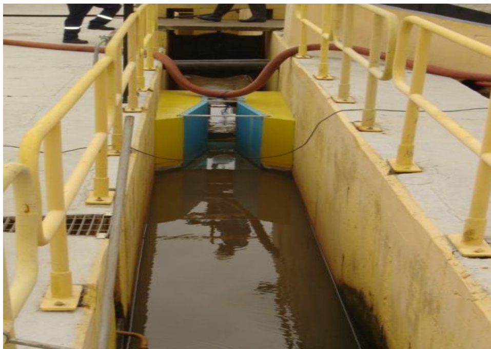
Figura 8 - Medidor de caudal Parshall
