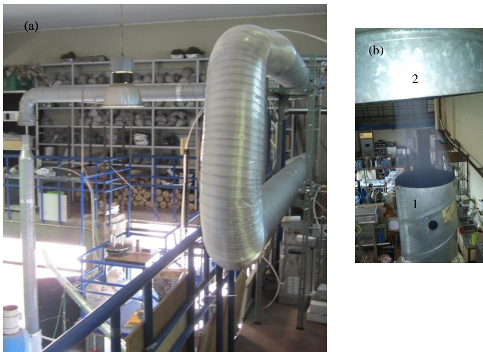
Figura 4.2. Túnel de diluição (a) Condução do túnel, (b) Seção de saída (1) e entrada (2) do efluente no túnel de diluição.
