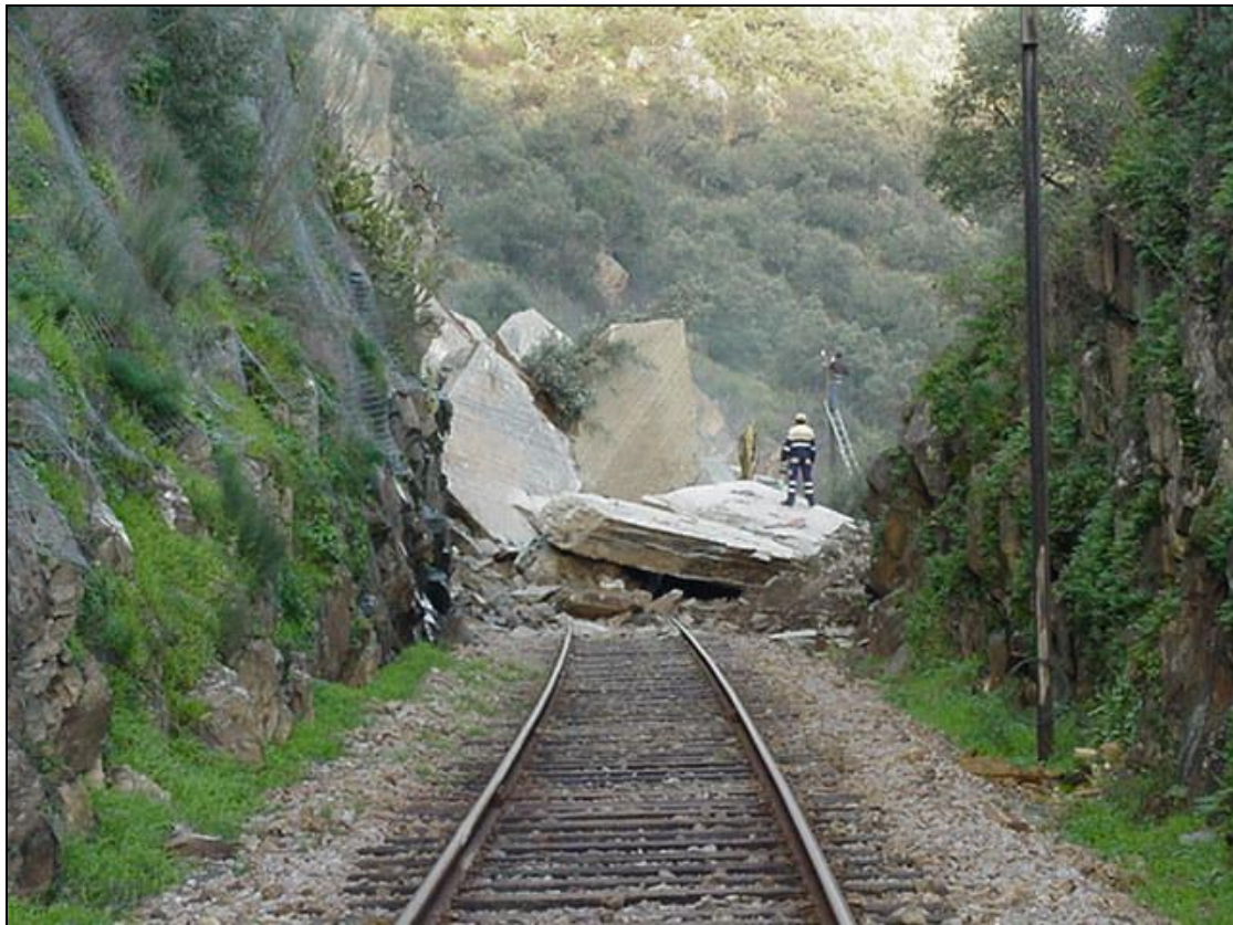
Figura 2.1 – Deslizamento de talude rochoso na linha do Douro, ocorrido em 2004.
