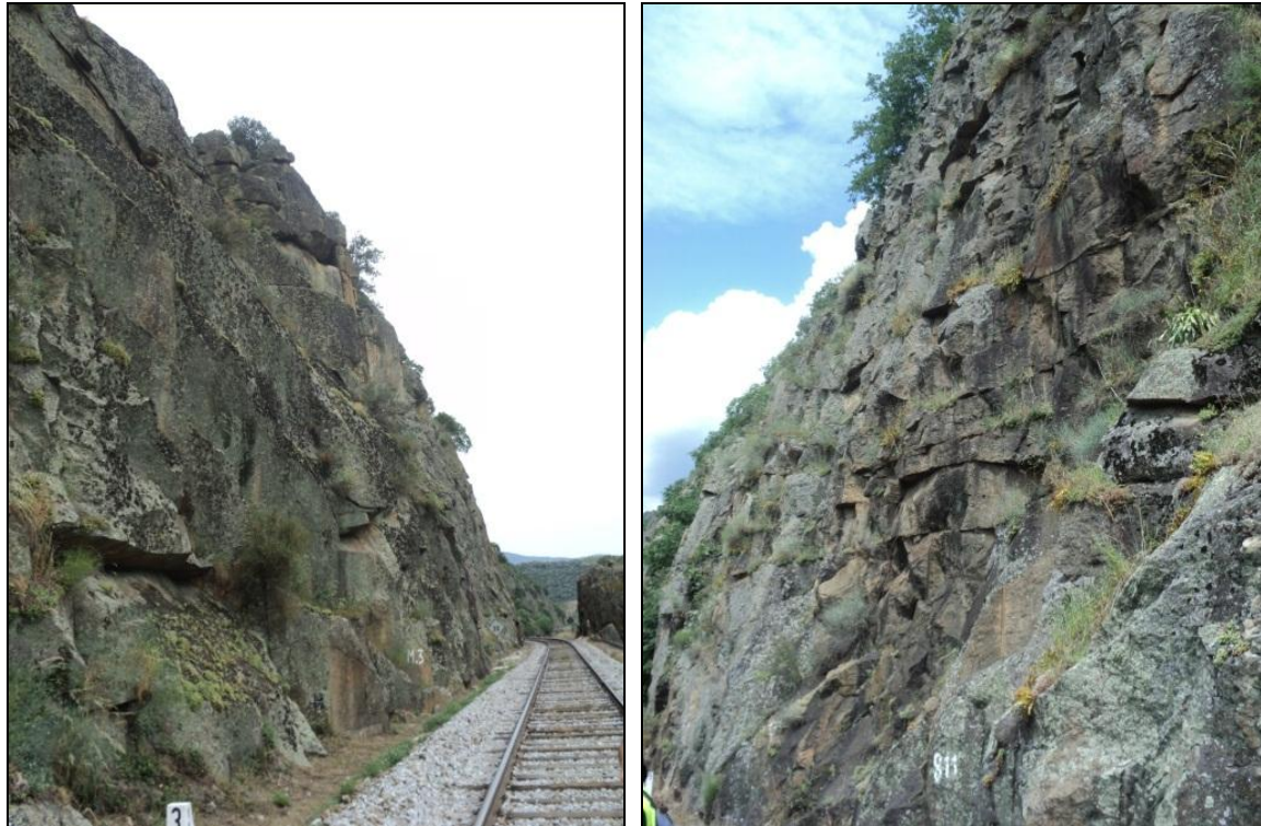
Figura 3.31 – Vista de zonas de potencial rotura no talude 2.
