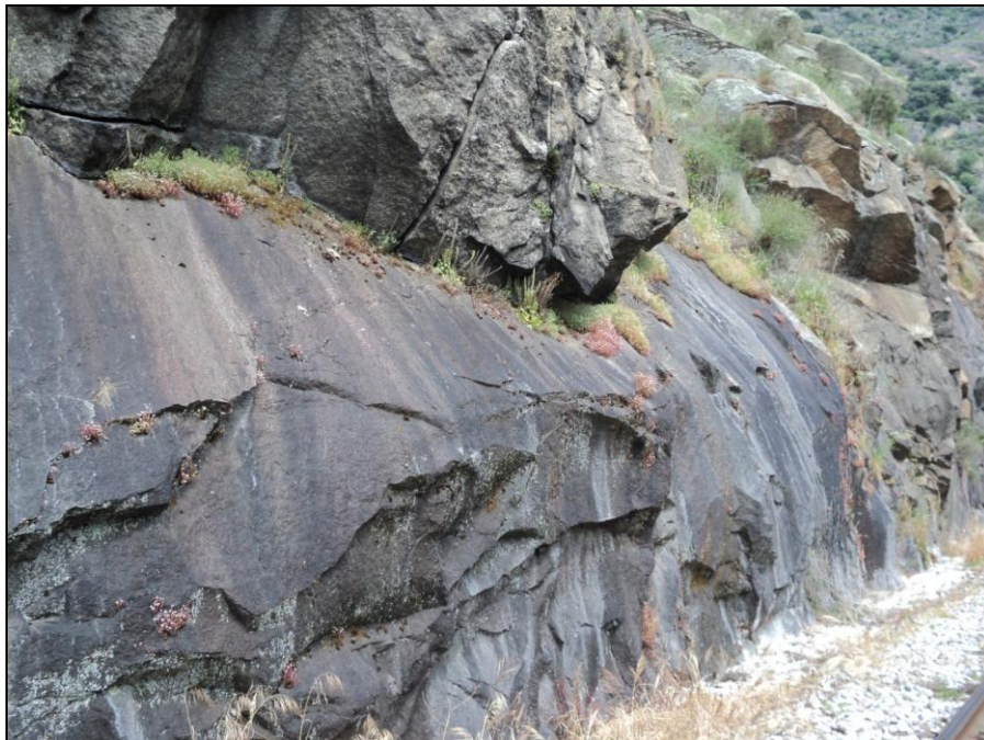
Figura 3.29 – Zona exemplificativa de rotura em cunha e planar no talude 1.
