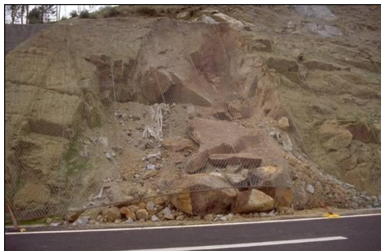
Figura 2.19 – Exemplo de redes suspensas, que permitiu a deposição e acumulação dos blocos na base do talude ( http://www.enrico-piolanti.pt ).
