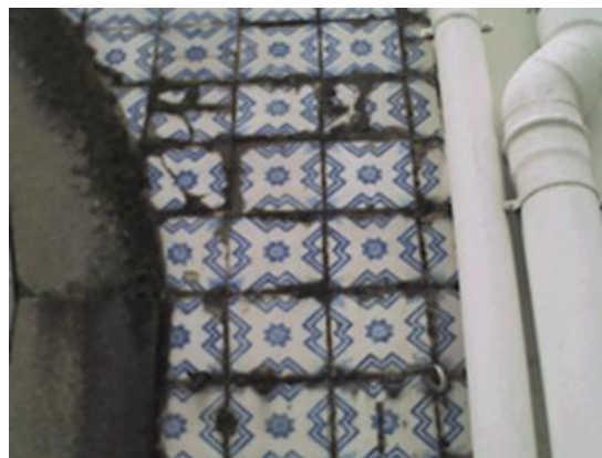
Figura 51. Colonização biológica intensa nas juntas entre azulejos e nas fraturas
