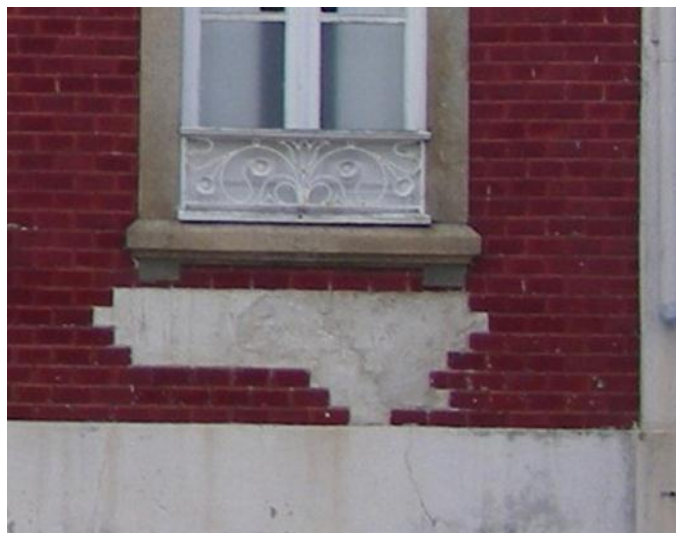
Figura 8. Desprendimento de azulejos devido à fissuração do suporte, agravado pela presença de humidade (Ovar).
