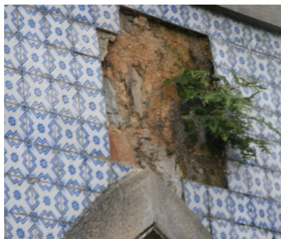
Figura 10. Desprendimento de azulejos e biodegradação (Ovar).
