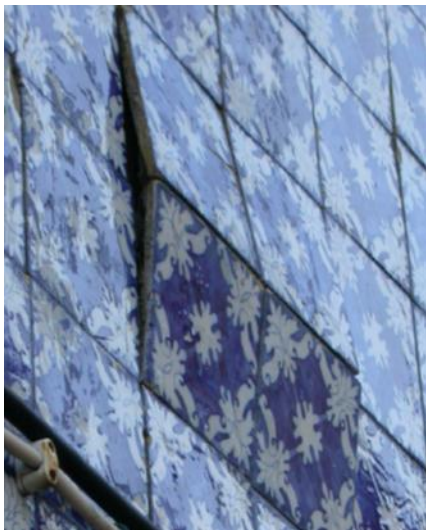
Figura 5. Descolamento e empolamento de vários azulejos (LNEC, 2011a).
