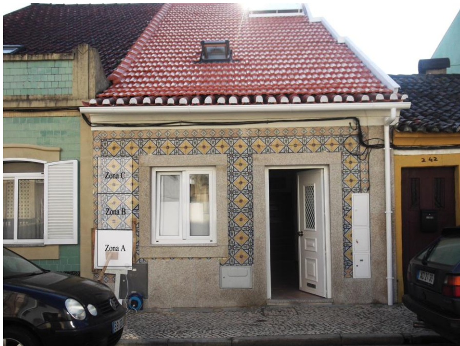
Figura 57. Mapeamento das zonas da fachada a estudar utilizando a placa de aquecimento.
