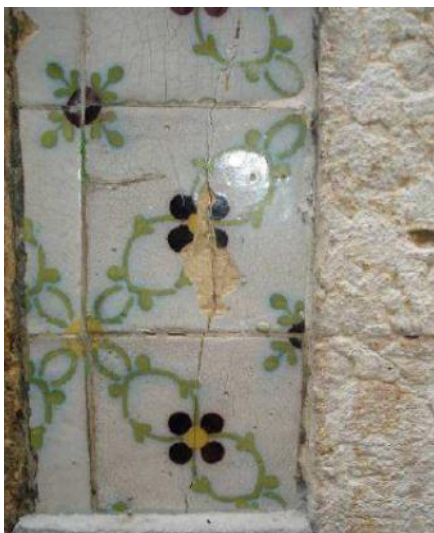
Figura 7. Fissuração de azulejos (LNEC, 2011b).
