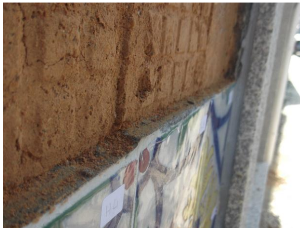
Figura 61. Azulejos colocados com argamassa de cimento.
