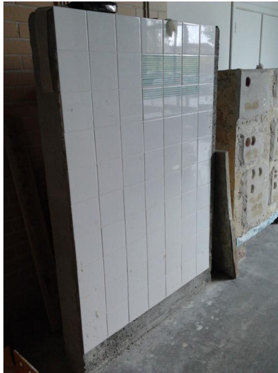
Figura 114. Parede de tijolo com revestimento de azulejos novos aplicados com cimento-cola.
