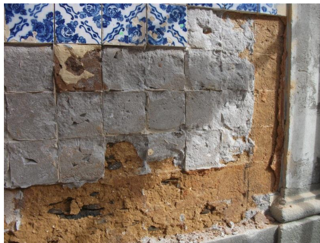
Figura 76. Estado das argamassas após a remoção de azulejos na zona C.
