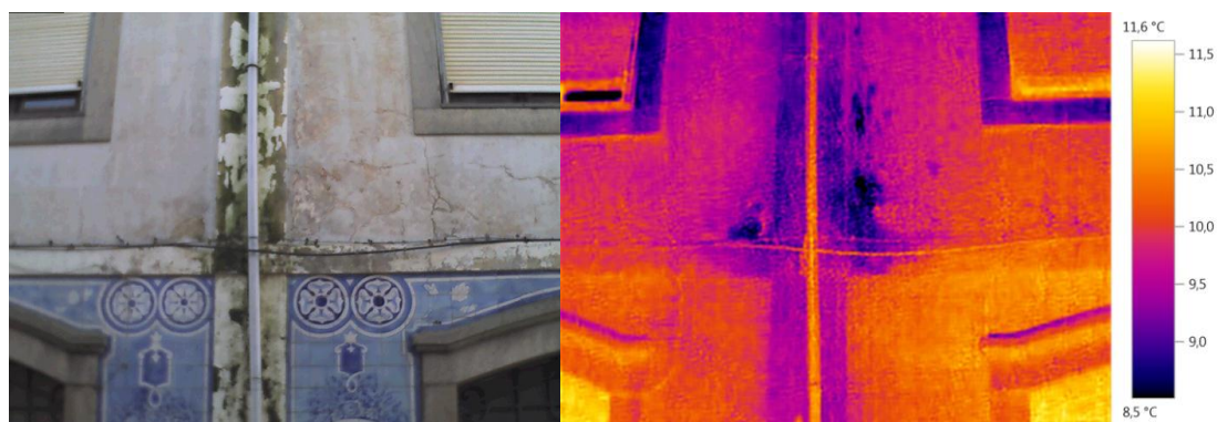
Figura 28. Identificação de temperaturas baixas na zona do pilar através da termografia (28a. Imagem real; 28b. Imagem termográfica).
