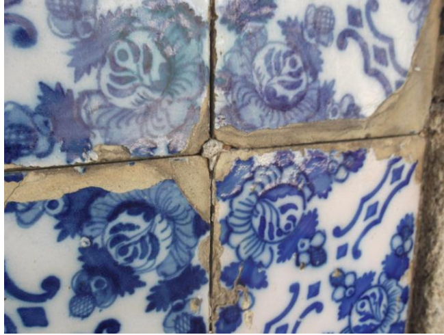
Figura 79. Pormenor de azulejos com vidrado destacado, indicando a possíveis infiltrações de água.
