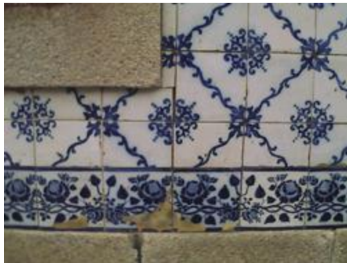
Figura 39. Destacamento de vidro de azulejos.
