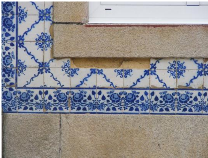
Figura 6. Desprendimento de azulejos na zona do peitoril (Ovar).
