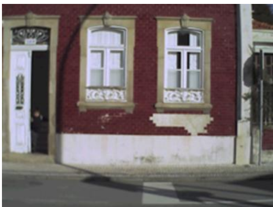
Figura 33. Destacamento de azulejos sob o peitoril da janela.
