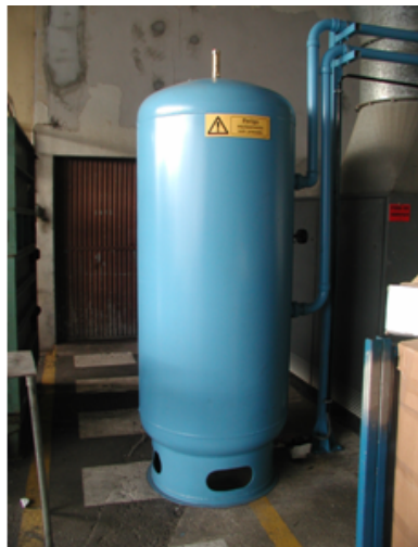
Figura 10 - Depósito de ar comprimido da Oliveira & Irmão, S.A
