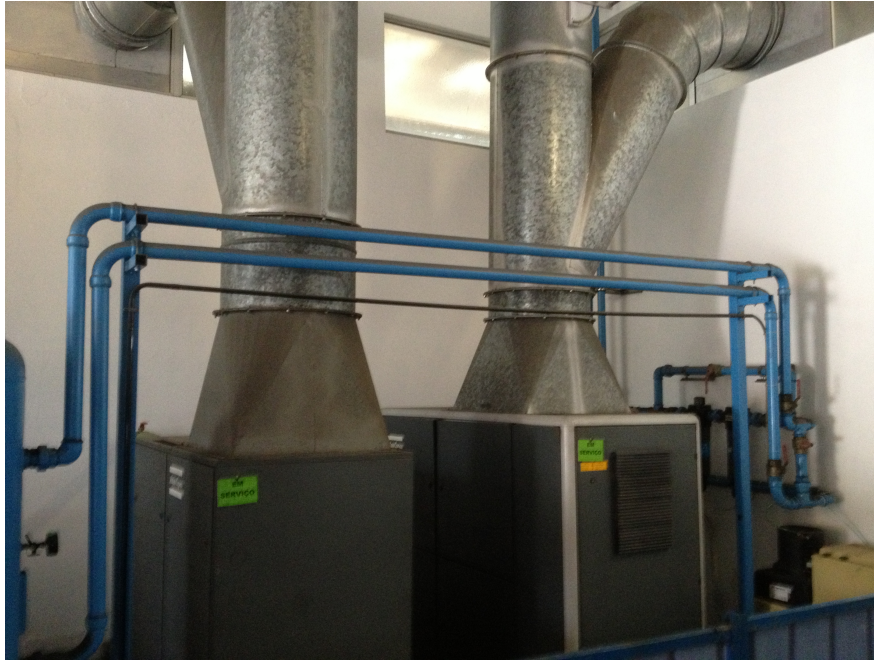
Figura 29 - Ligações da rede de ar comprimido da Oliveira & Irmão, S.A.
