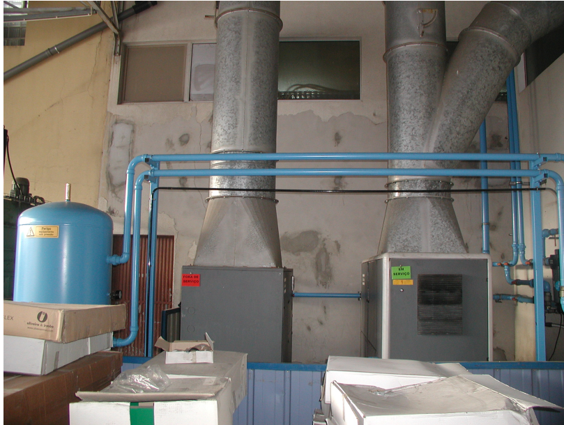
Figura 28 - Zona dos compressores da Oliveira & Irmão, S.A.
