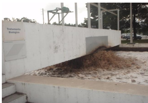
Figura 5.1 – Arejamento no tanque de lamas ativadas
