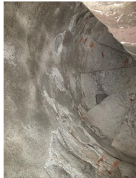
Fig. 4.14 Revestimento de argamassas no pano de parede da escada de caracol que dá acesso à torre sineira da Sé do Funchal
