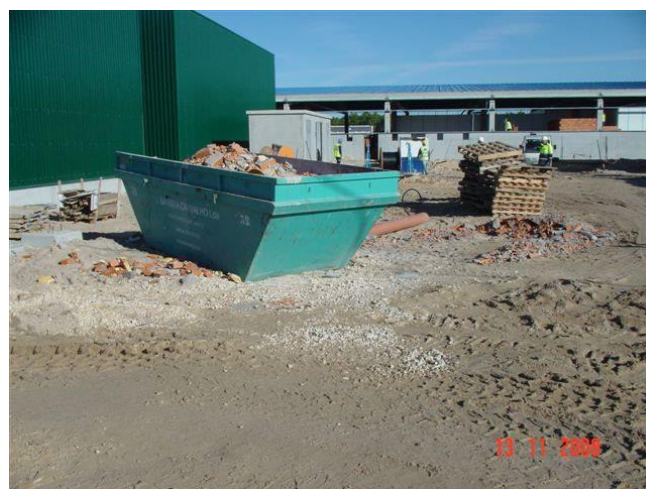
Figura 121 - Contentor para material inerte
