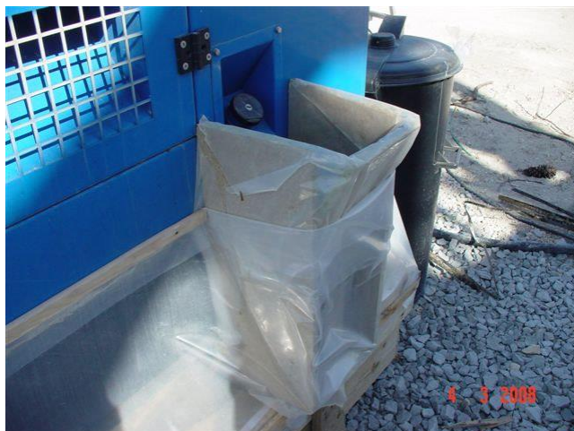
Figura 26 - Protecção do gerador
