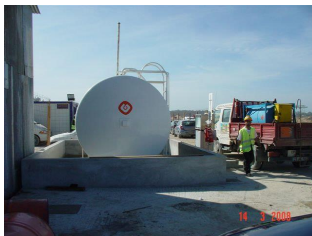
Figura 27 - Depósito de gasóleo colocado em zona impermeabilizada
