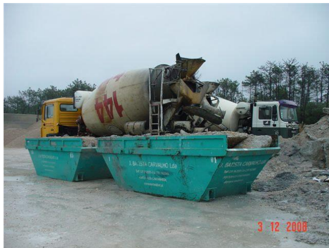
Figura 123 - Contentores de resíduos de betão
