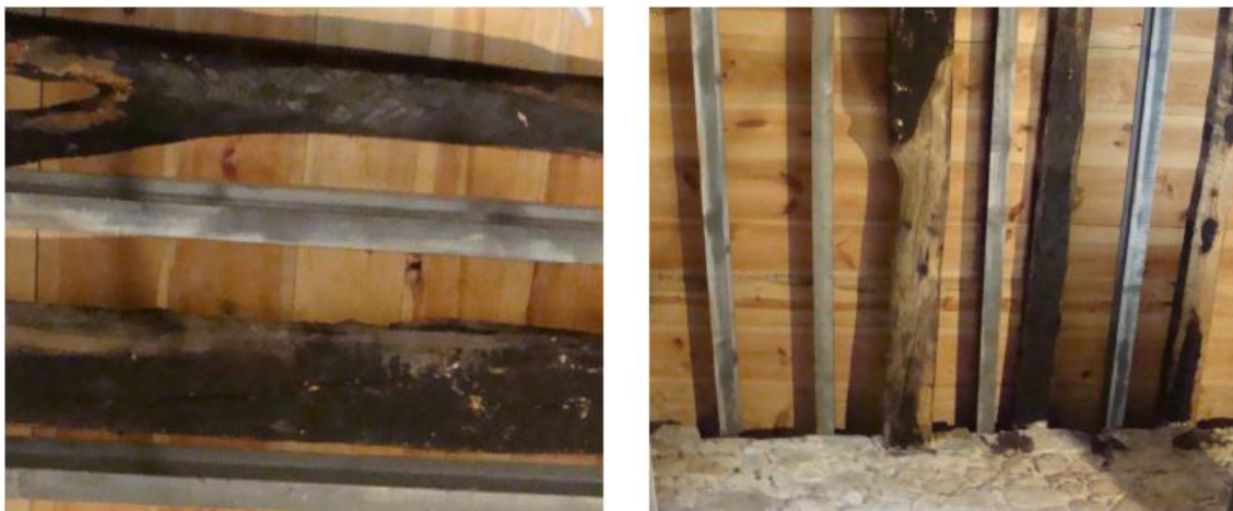
Figura 31 – Vigas de madeira carbonizadas (Mosteiro de Tibães)
