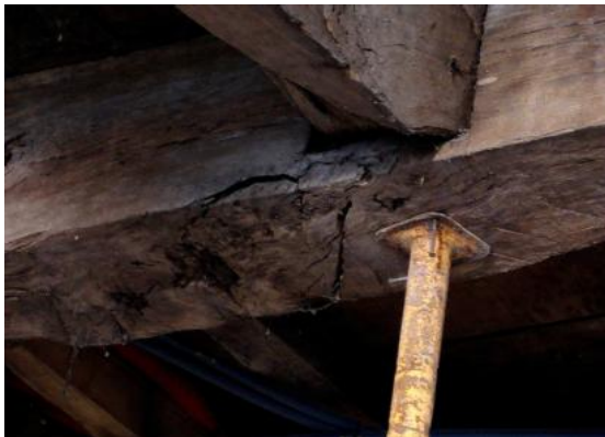
Figura 35 – Fendilhação provocada pelo aumento de cargas na estrutura de madeira (Portaria do Mosteiro de Pombeiro, Felgueiras) [Martins, 2009].
