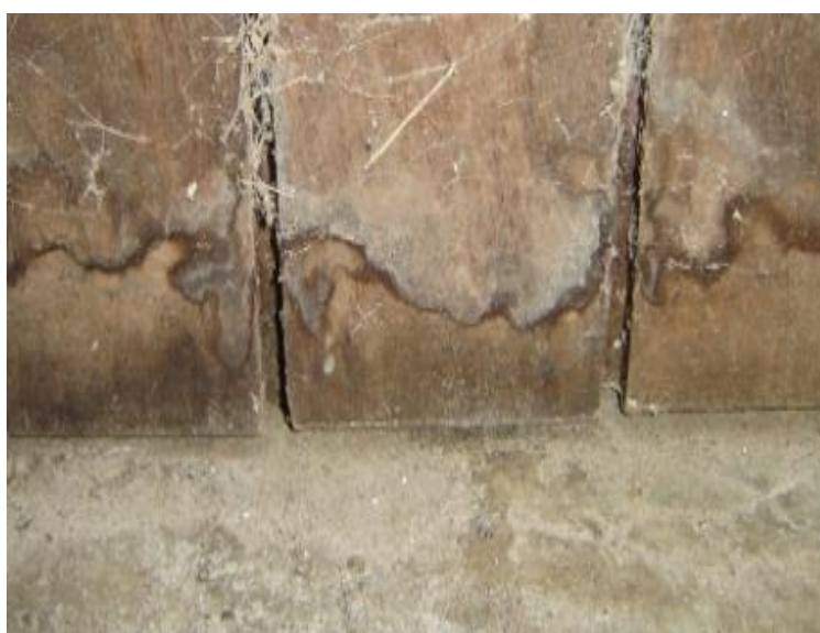
Figura 29 – Manchas na Madeira devido á absorção de água por capilaridade
