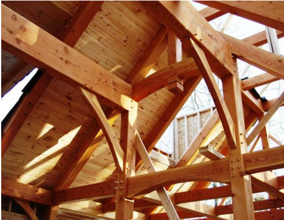
Figura 50 – Estrutura de cobertura aparafusada [www.engenhariacivil.com]
