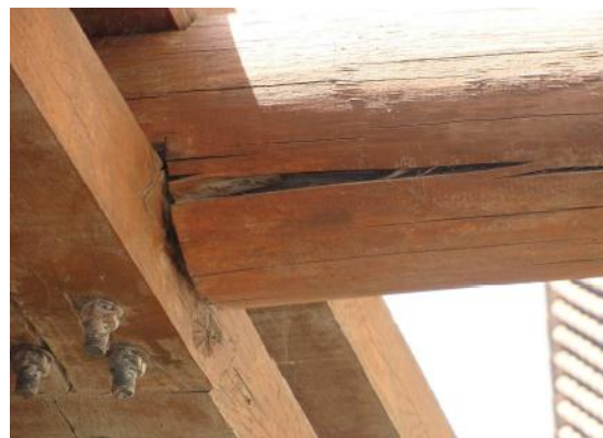
Figura 38 – Possível fendilhação devido a insuficiente resistência à tração (Picadeiro D'El Rei, Almeida) [Martins, 2009].
