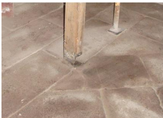
Figura 37 – Redução de secção num apoio de um pilar (Portaria do Mosteiro de Pombeiro) [Martins, 2009].
