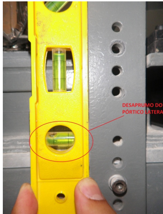
Imagem 2: Pórtico lateral desaprumado.
