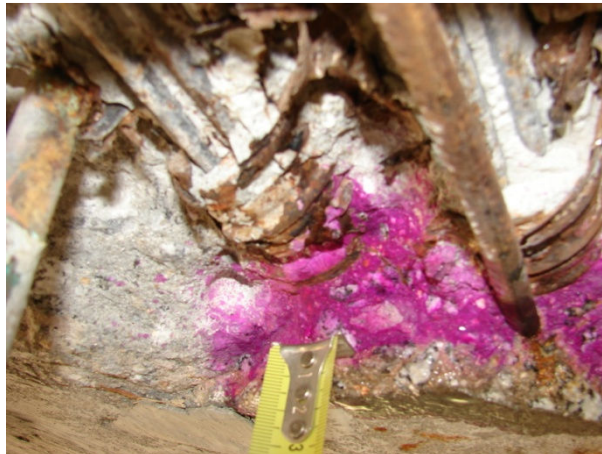
Figura 47: Medida in situ da profundidade de betão carbonatado numa janela de inspeção realizada na estrutura sita no p.k. 32 + 090 sentido A.
