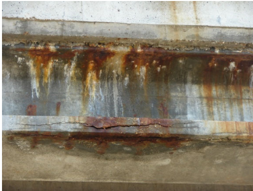
Figura 52: Escorrências de água e o estado do banzo inferior da viga (face exterior)
