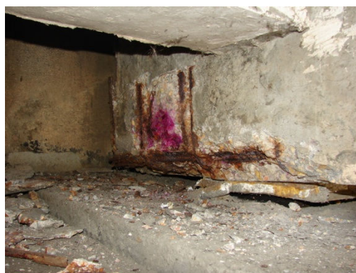
Figura 63: Estado da zona de apoio.
