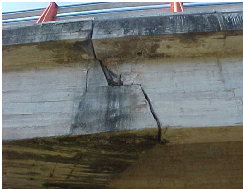
Figura 39: Deterioração da junta de dilatação, que propicia as escorrências de água e subsequente degradação dos materiais constituintes.
