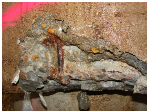
Figura 58: Esquina da face lateral com a inferior com corrosão de um capitel, cuja armadura apresenta corrosão.
