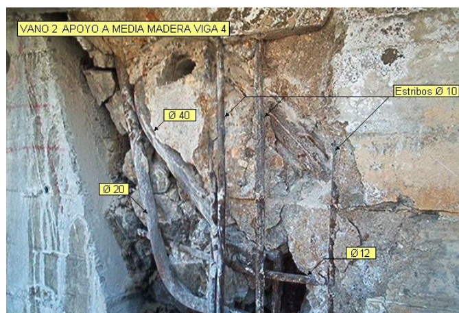
Figura 44: Vista de uma janela de inspeção realizada para determinar a configuração das armaduras e a sua secção residual.
