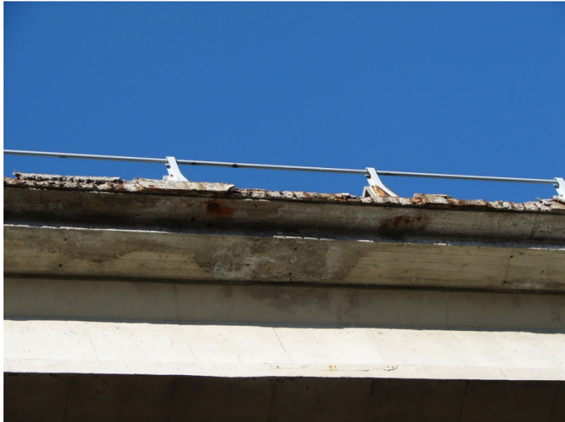
Figura 41: Danos no tabuleiro do viaduto, situado no p.k. 19 + 090 sentido B, devido a escorrências de água pela cornija.
