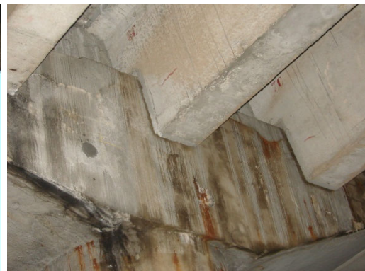
Figura 67: Outro capitel com escorrências de água e manchas de corrosão.
