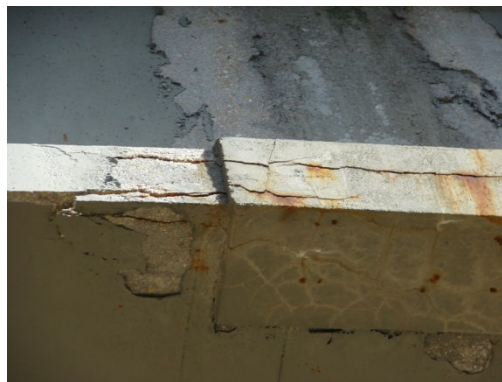
Figura 61: Detalhe da Figura 60, com fissuras na zona reparada.
