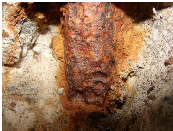
Figura 2: Picaduras na armadura por ataque de íões cloreto.
