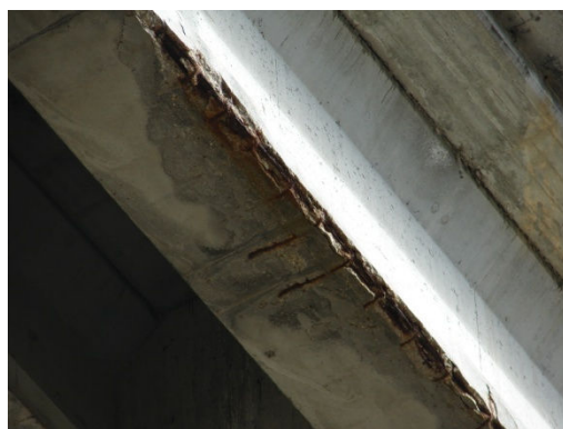
Figura 62: Destacamento do betão de recobrimento das armaduras.
