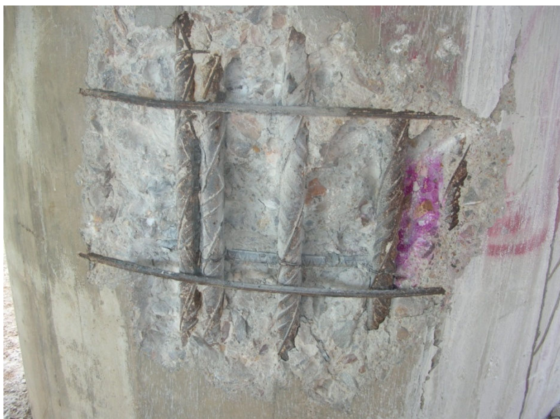
Figura 1: Início dos processos de corrosão das armaduras por carbonatação do betão de recobrimento.
