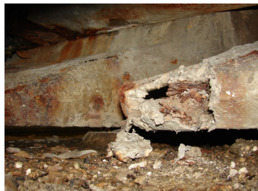
Figura 55: Detalhe do destacamento do betão e corrosão das armaduras, numa zona de apoio intermédio sob uma junta de dilatação.
