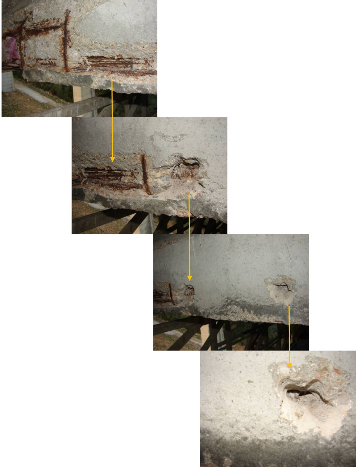
Figura 68: Três janelas de inspeção realizadas numa viga exterior da estrutura localizada no p.k. 3 + 590: uma em zona com escorrências de água e as restantes progressivamente mais afastadas da primeira. Pormenor da terceira janela de inspeção.
