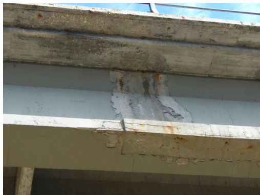
Figura 60: Fissuração da face inferior e longitudinal da viga exterior, quer em zonas reparadas como na face original.
