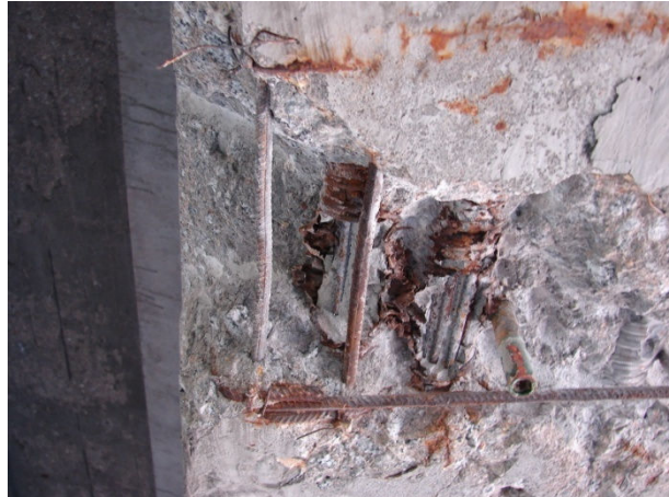
Figura 45: Início dos processos de corrosão na armadura ativa no viaduto localizado no p.k. 12 + 718 sentido B.
