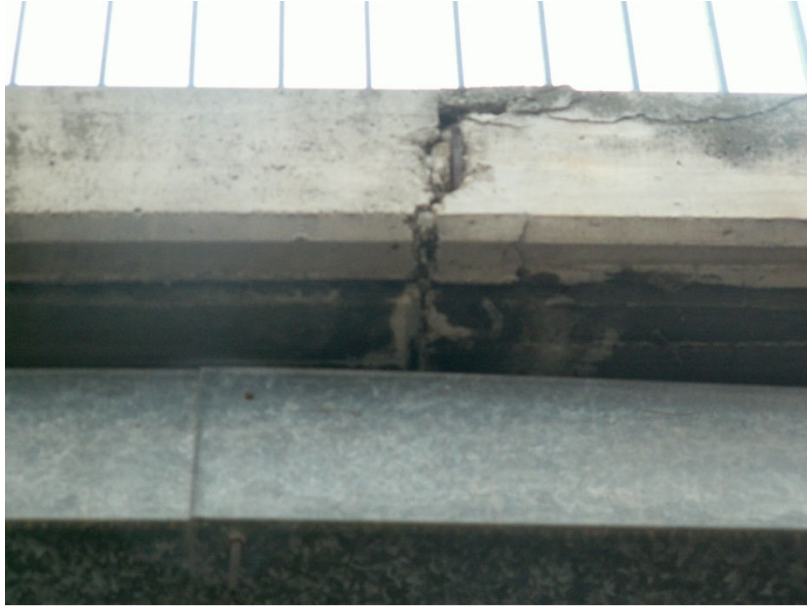
Figura 40: Deterioração da junta de dilatação e escorrências de água através da mesma.
