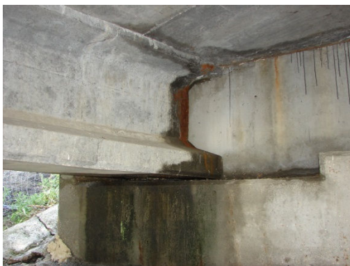
Figura 54: Escorrência de água na cabeça de uma viga junto a um dos encontros, sob uma junta de dilatação.
