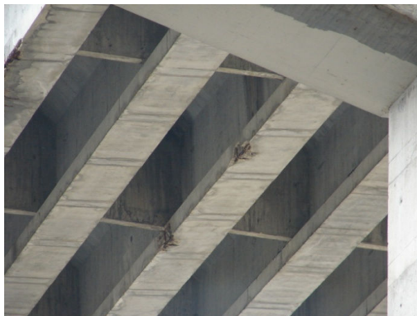
Figura 42: Danos em vigas interiores associados a filtrações de água através da laje do tabuleiro da estrutura sita no p.k. 3 + 590.
