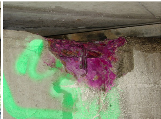
Figura 57: Vista de uma janela de inspeção cujas armaduras apresentavam corrosão (sem perda de secção).
