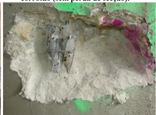
Figura 59: Armaduras de um pilar com picaduras.
