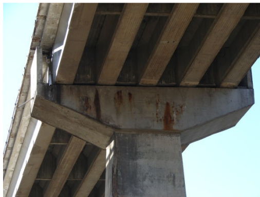
Figura 66: Vista de um capitel com escorrências de água e manchas de corrosão.
