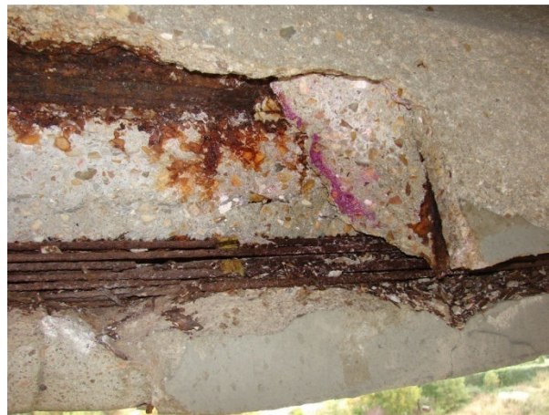
Figura 46: Rotura de alguns cabos de pré-esforço no viaduto localizado no p.k. 3 + 590 sentido A.
