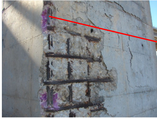
Figura 64: Estado de um pilar de uma das estruturas.
