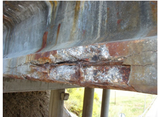
Figura 53: Estado da armadura na zona com escorrências. Armadura passiva com corrosão intensa e armadura ativa com indícios de corrosão (sem perda de secção nominal).
