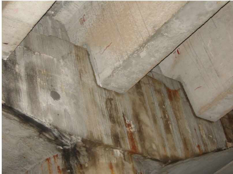
Figura 38: Escorrências em pilares e capitéis, provenientes da junta de dilatação existente no tabuleiro da obra de arte localizada no 12+718 sentido B
