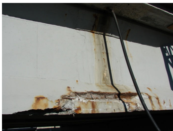
Figura 43: Danos em vigas causados por um sistema de drenagem em mau estado de conservação. Obra de arte localizada no p.k. 29 + 390 sentido B.
