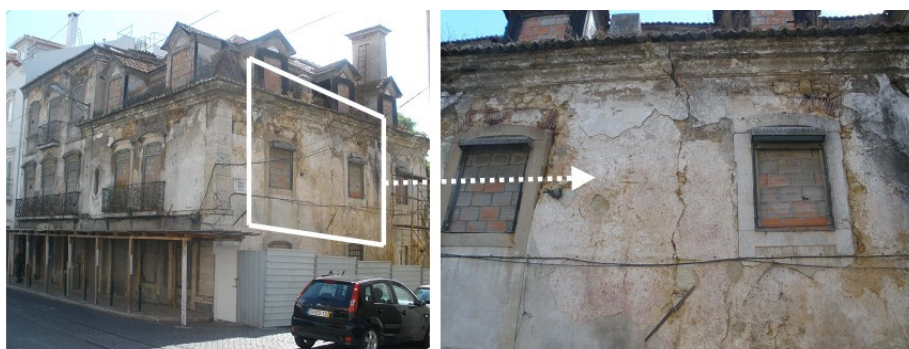
Figura 4: Fendilhação de uma parede. Fonte: [19].
