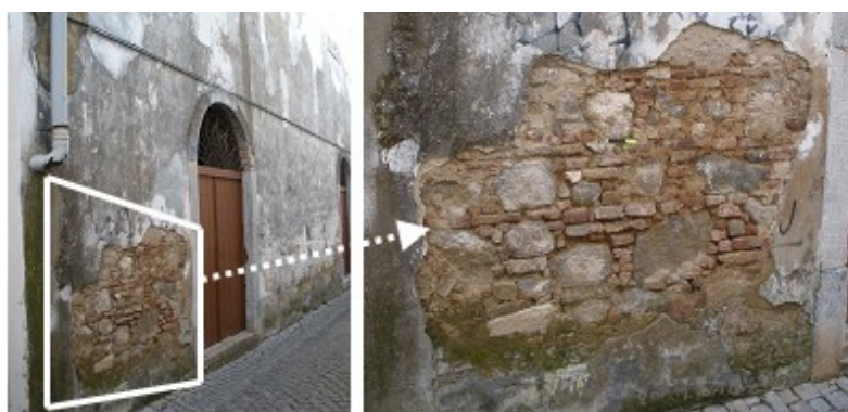
Figura 9: Desagregação da alvenaria. Fonte: [19].
