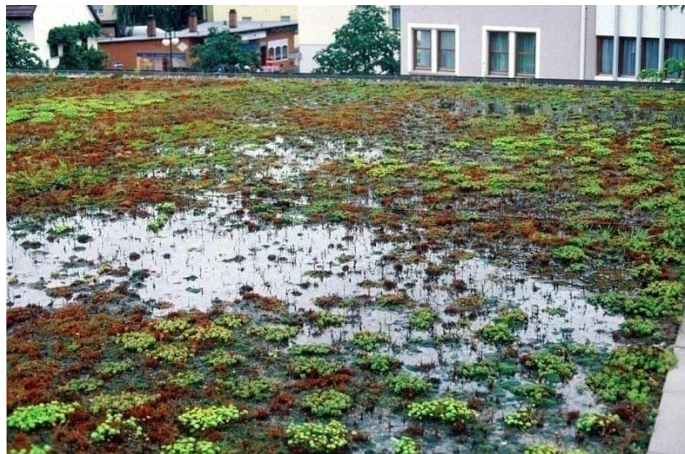
Figura 2.11 Cobertura ajardinada com problemas de encharcamento e sobrecarga (Fonte: Pereira et al. , 2012)
