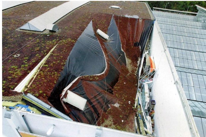
Figura 2.12 Colapso da estrutura pelo inadequado sistema de drenagem instalado (Fonte: Pereira et al. , 2012)
