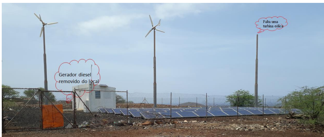
Figura 6.48 - Central híbrida do Vale da Costa (Fonte: autor, julho de 2020).
