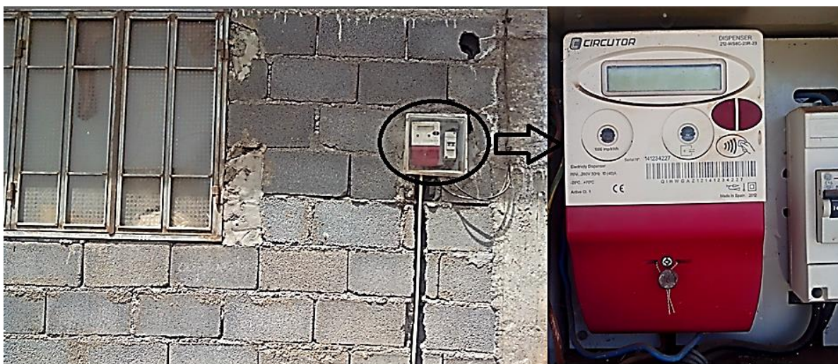
Figura 6.2 - Primeiros contadores da eletricidade instalados numa moradia no Vale da Custa (Fonte: autor, 2017).
