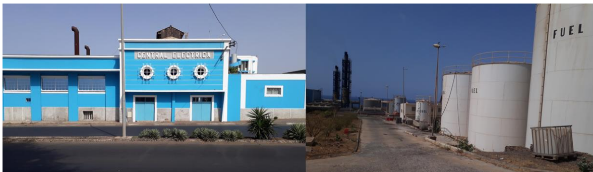
Figura 4.2 - Central Termoelétrica do Palmarejo Grande na Ilha de Santiago (Fonte: Autor).
