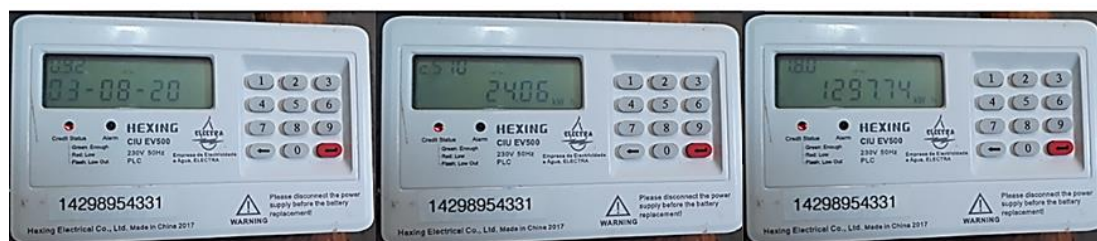
Figura 6.49 - Contador da energia elétrica (Fonte: autor, agosto de 2020).
