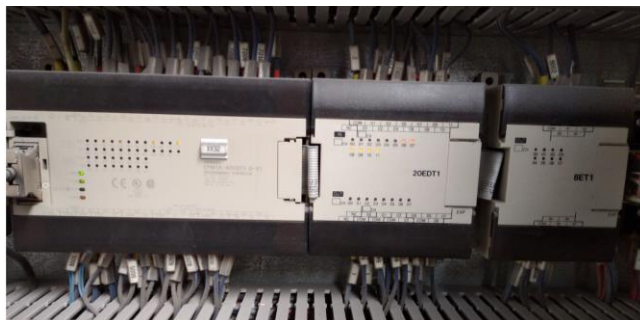
Figura 30 – Controlador do processo na saída do forno
