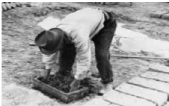
Figura 3 - Observa-se a mistura de areia, cal e fibras de palha num molde de madeira com as dimensões do bloco de adobe e a disposição de adobes para secar ao ar livre (Araújo, 2004)
