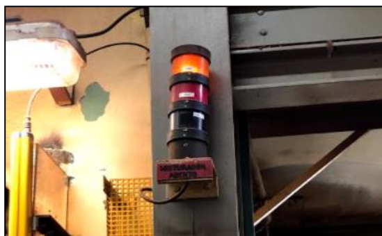
Figura 52 - Sinal luminoso (laranja) de “misturador parado”
