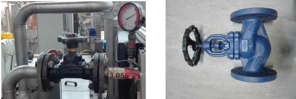
Figura 4.17: Válvula da máquina 2288, válvula de membrana à esquerda e válvula de globo à direita .
