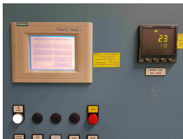
Figura 3.12: Quadro elétrico Banco Endurance: HMI e controlo da temperatura.
