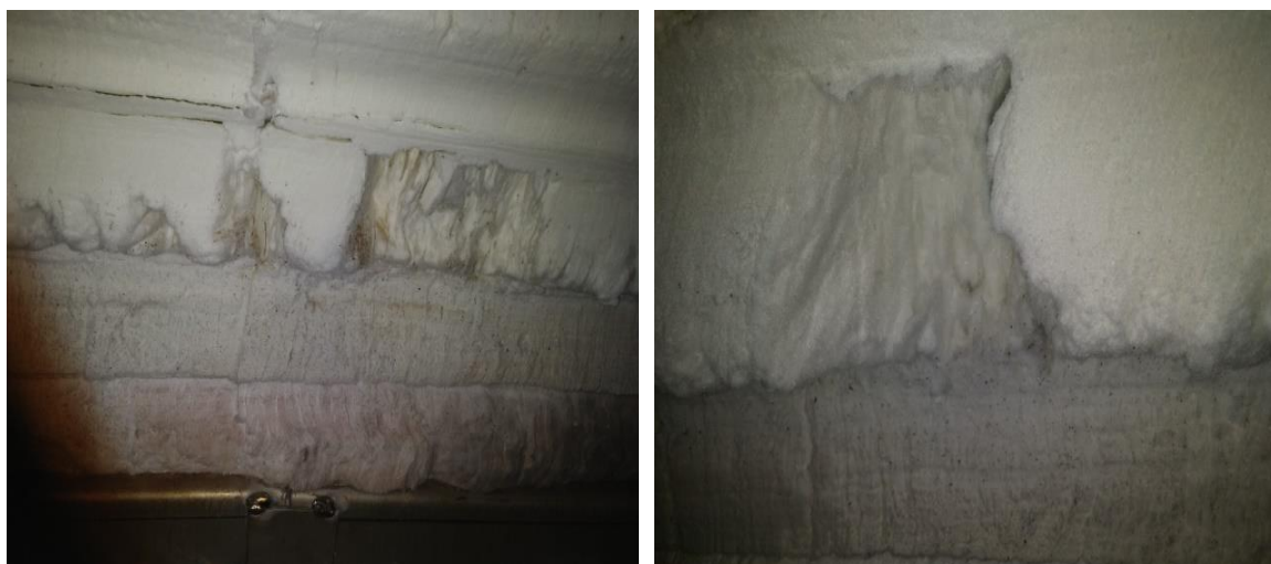
Figura 3.18 – Imagens das falhas de fibra no interior do forno.
