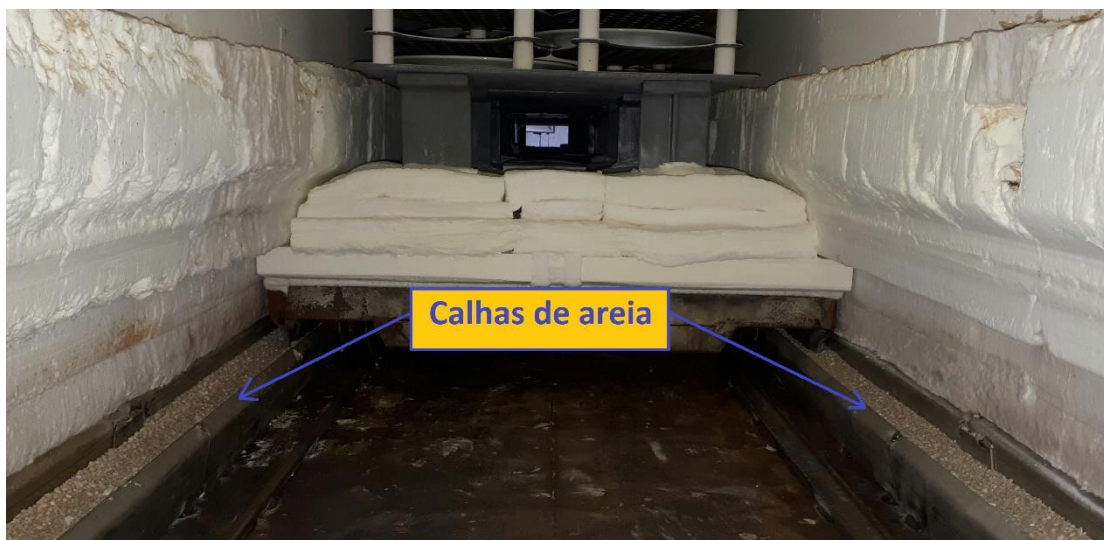
Figura 3.16 – Calhas de areia, no interior do forno.
