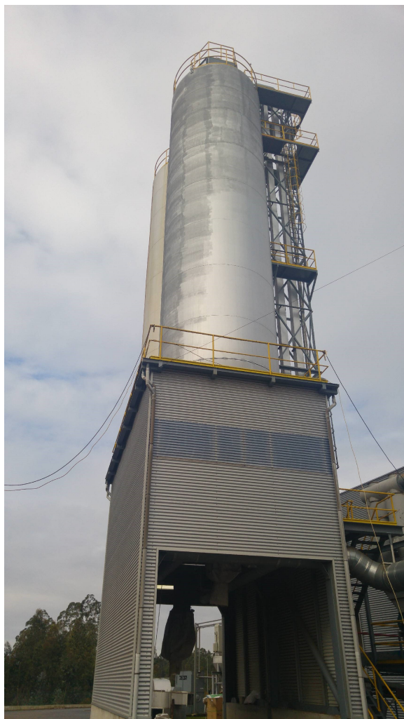
Figura 14: Silos para armazenagem dos pellets.
