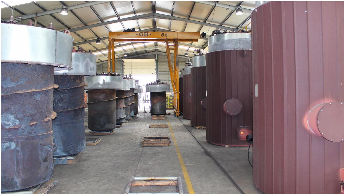
Figura 12- Instalação dos fornos fixos de produção de carvão vegetal da Ibero Massa Florestal S.A..
