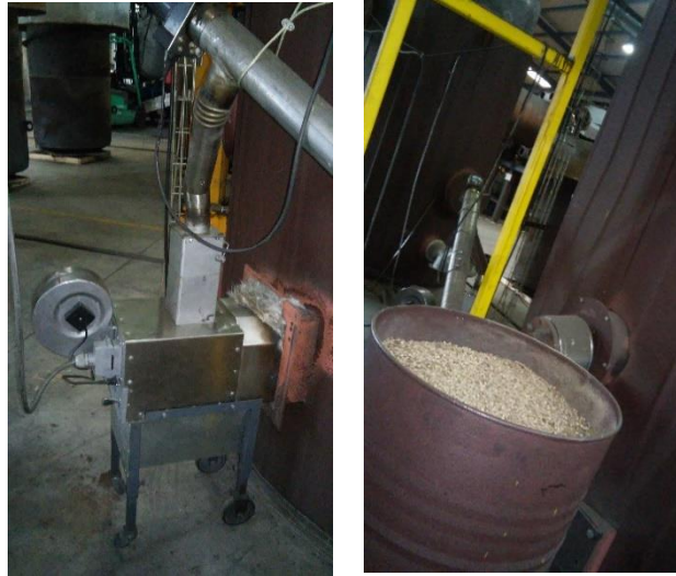
Figura 14- Queimador externo (lado esquerdo) e o respetivo combustível auxiliar (lado direito).
