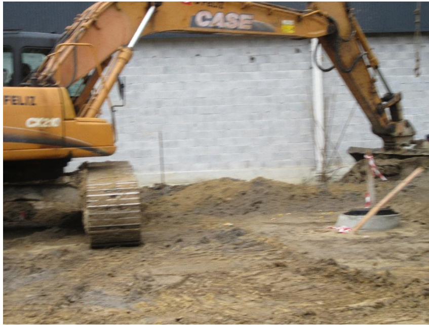
Figura 5.9 - Retroscavadora a limpar a boca do furo da estaca (fotografia da autora)
