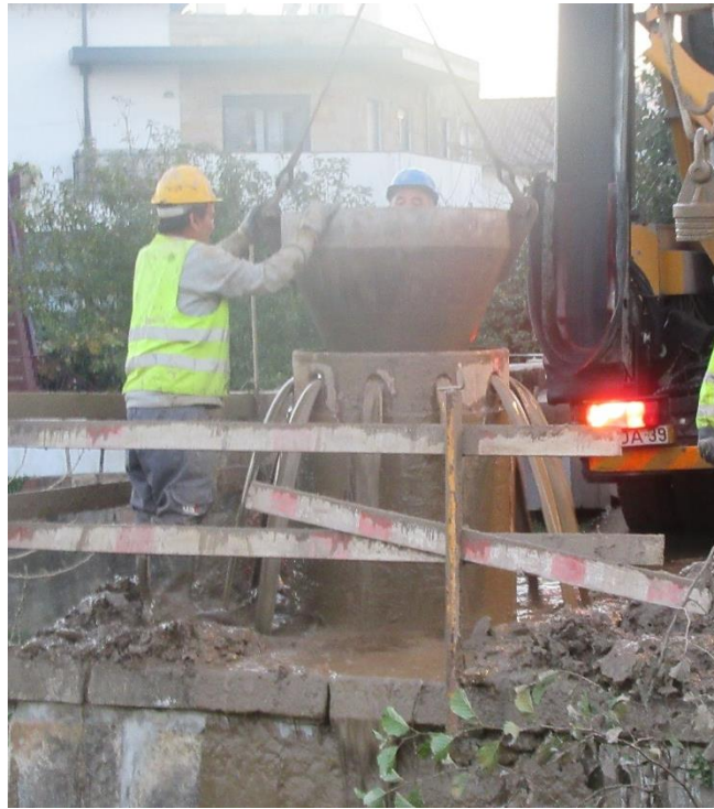
Figura 5.26 - Visualização da água a sair do furo durante a betonagem (fotografia da autora)
