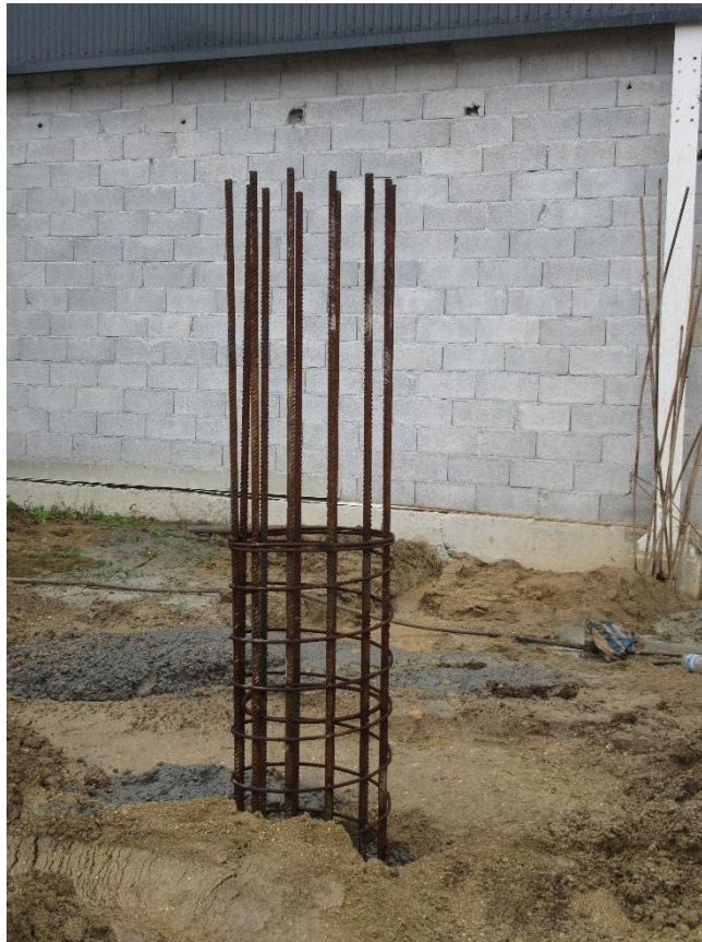
Figura 5.13 - Armadura retida pelo betão (fotografia da autora)
