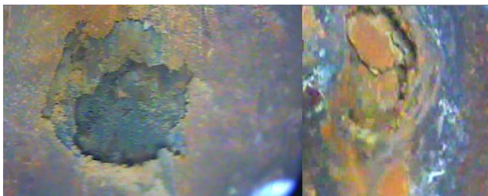
Figura 6.8 - Corrosão da tubagem ocorrendo a perfuração da mesma.
