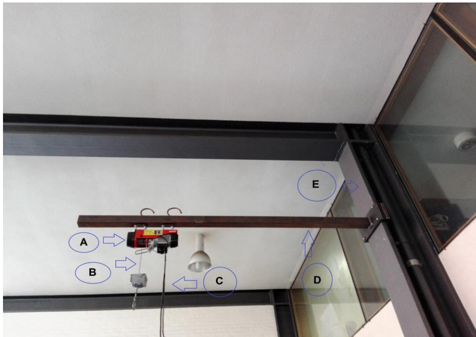
Figura 2.4 – Guincho e respetiva viga de suporte: (A) guincho; (B) cabo de aço; (C) fio elétrico de alimentação do guincho; (D) viga de suporte do guincho; (E) coluna mestra do DEM.
