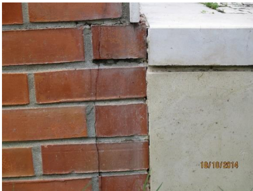
Fig. 6.11 - Fissuração da interface de contacto entre dois materiais diferentes (UA)
