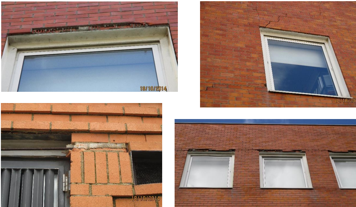
Fig. 6.23 - Casos de fissuração em zona de vão (UA)
