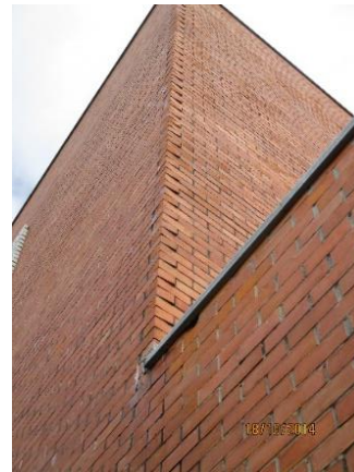
Fig. 6.10 - Fissuração em zona de mudança de cota da base de assentamento em tijolo face à vista (UA)
