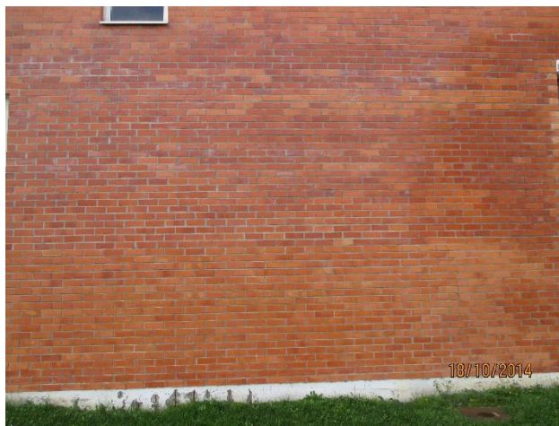
Fig. 4.10 - Pano TFV sem soluções de ventilação ou drenagem (UA)
