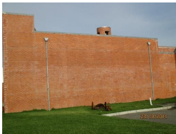
Fig. 6.9- Pano extenso em tijolo face à vista sem a aplicação de juntas de movimento (UA)
