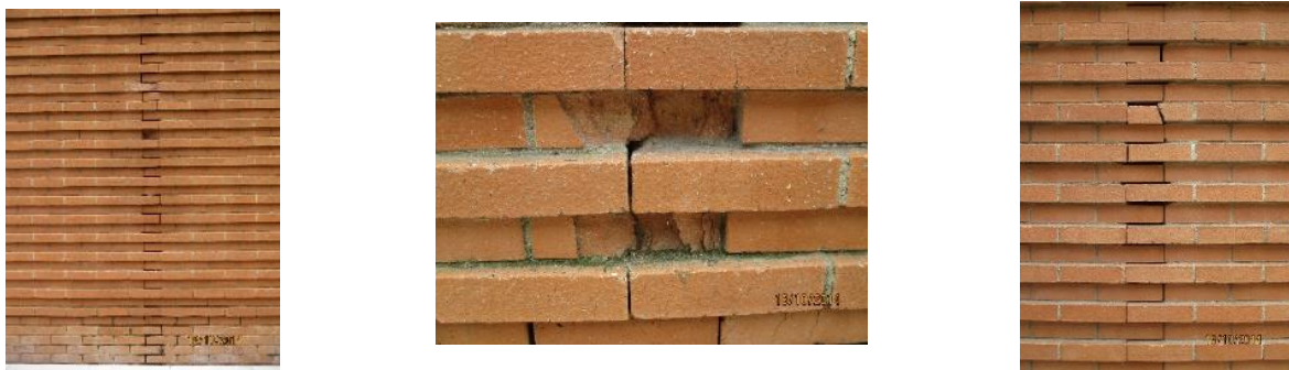
Fig. 6.6 - Fissuração em pano de grandes dimensões (UA)
