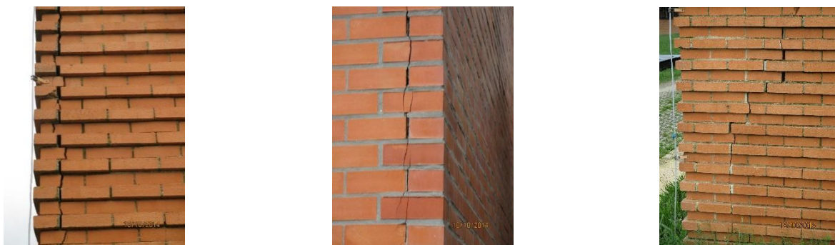
Fig. 6.1- Fissuração típica em cunhais (UA)
